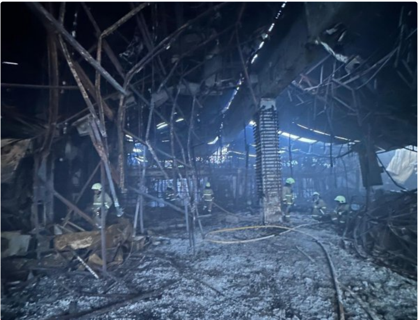
Glodok Plaza yang Hangus Terbakar
